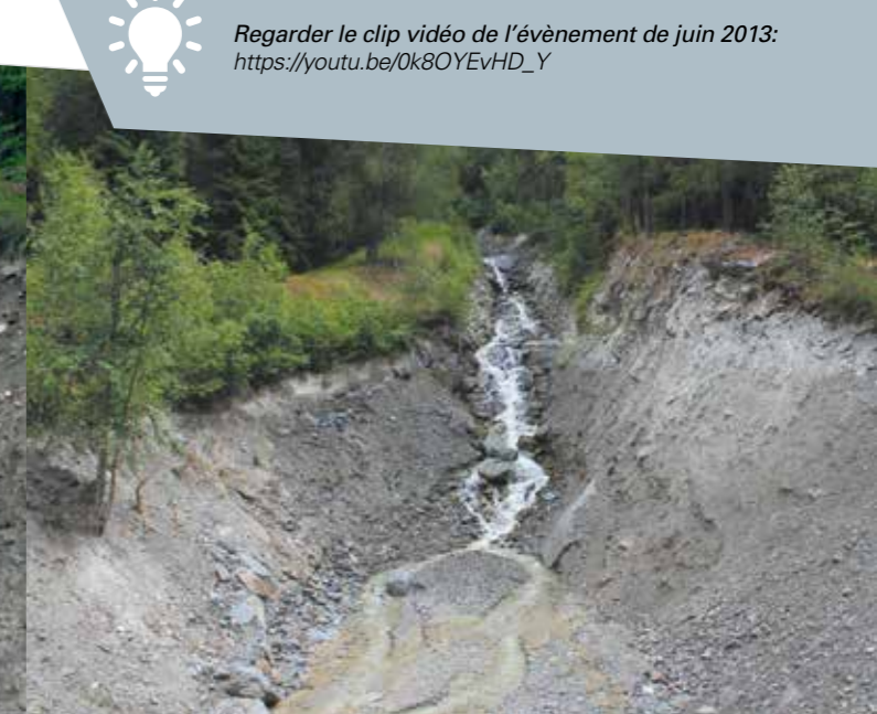
18.6.2013: situation normale du bassin, après avoir été vidé en urgence
