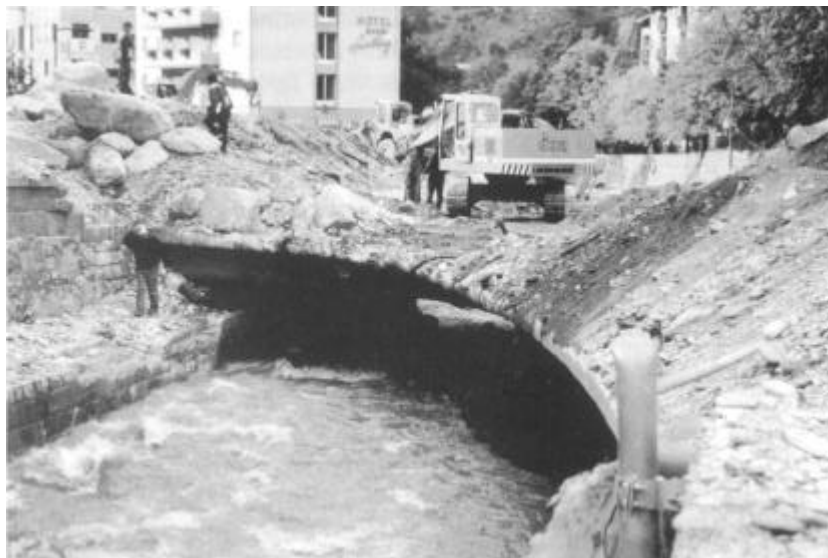
Photo 1. Vue de la bordure amont du pont de la Saltina, situé au sommet de la ville de Brigue, pendant les travaux de déblaiement. Il faut relever la taille importante de certains blocs de rocher charriés par la crue, ainsi que la faible hauteur d'écoulement sous le tablier du pont. [Photo OFEE, 26.09.1993].
