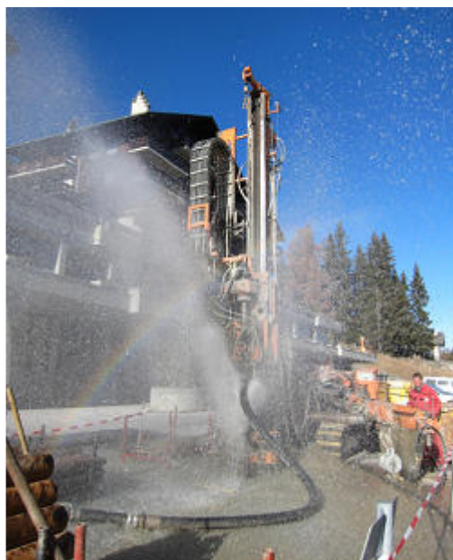
Figure 3 : Glissement des Masses : soufflage dans l'aquifère identifié comme source potentielle de glissement © BEG SA 2011
